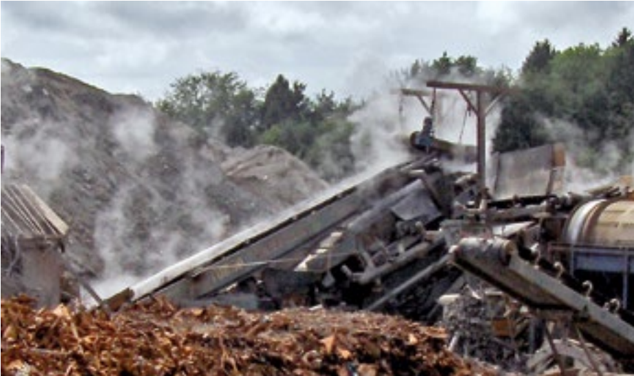
Bei der offenen Verarbeitung von KVA-Schlacken, z.B. zur Metall-Rückgewinnung, können Nanopartikel als diffuse Emission in die Umwelt austreten.
