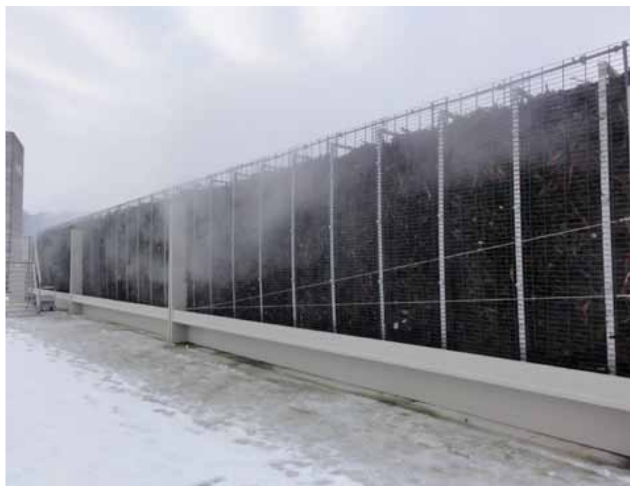
Biofilteranlage noch ohne Kamin
