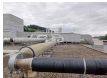
Sammelabluftrohre im Vordergrund. Im Hintergrund sind die 4 Kamine der Biofilteranlage zu sehen.
