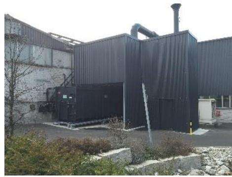
und mit neuer Abluftreinigung(Container)
