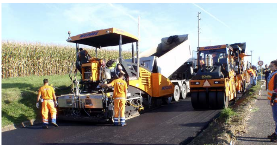
Abbildung 2: Einbau eines Niedertemperatur-Asphaltbelages im Parallelbetrieb mit zwei Fertigern (vorne links) und mehreren Walzen. Fotos: Alexander Winkler
