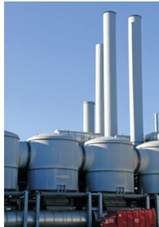
Beispiel einer VOC-Abluftreinigungsanlage.
